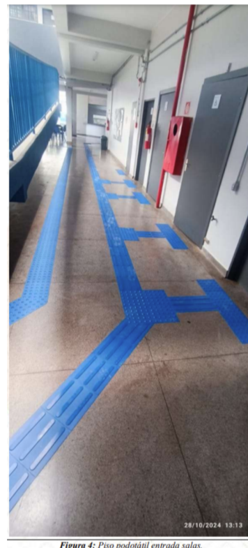
Figura 4: Piso podotátil entrada salas.
